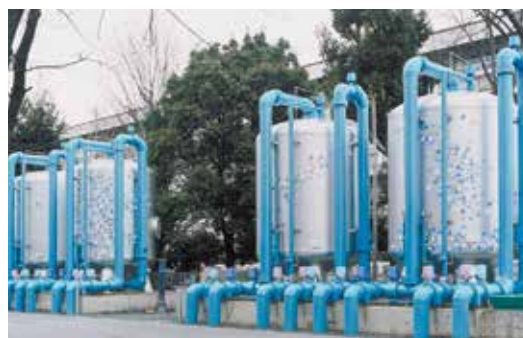
浄水場濾過槽
